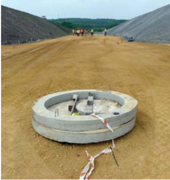
Φωτ. 4 — Κατασκευή οδών και εγκαταστάσεων υπηρεσιών κοινής ωφέλειας σε χώρους απόθεσης αποβλήτων πρώην ανθρακωρυχείου (Jaworzno, Πολωνία)
