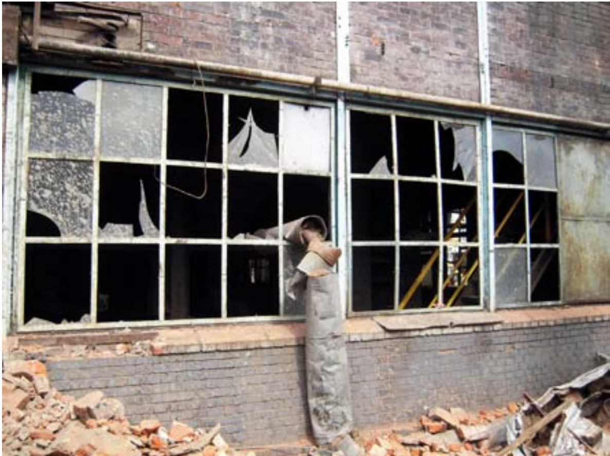
Φωτ. 8 — Κατεδάφιση και ανακαίνιση παλαιών κτιρίων σε εγκαταλελειμένο σταθμό παραγωγής ενέργειας που μετατρέπεται σε κέντρο τεχνών και πολιτισμού (Λότζ, Πολωνία)
