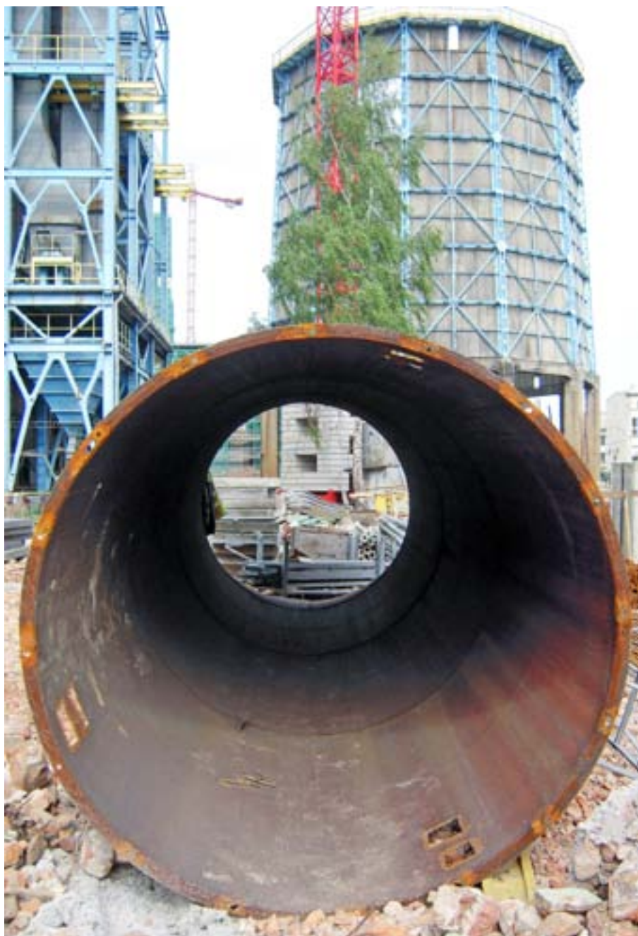
Снимка 1 — Ремонтване и преустройство на емблематична кула на изоставена електроцентрала в центъра на града, която се преобразува в център за изкуства и култура (Łódź, Полша)
