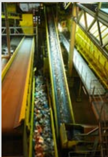
Foto 1 — Impianto di cernita
