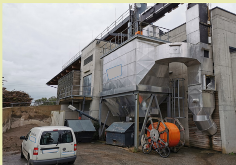
Centrală termică locală în Austria (măsura 321, beneficiar privat) Costuri eligibile: 5 300 087 de euro Finanțare publică: 50 %
