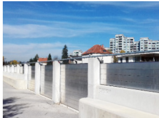
Dique fluvial com paredes amovíveis que permitem a inundação controlada de uma das margens do rio, a fim de proteger a outra margem, densamente povoada (Eslovénia)
